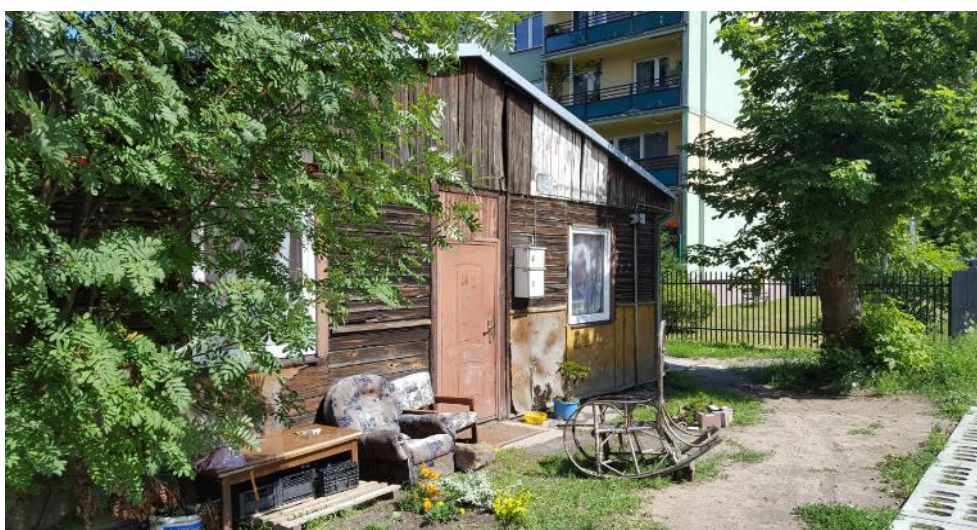
Fotografia 5. Zły stan techniczny większości budynków socjalnych przy ul. Warszawskiej 250
